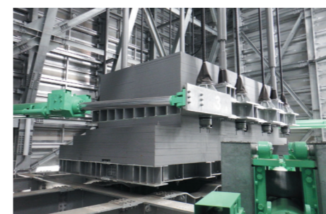
④ D³SKY® 屋上に設置する振り子型の制震装置。鋼製ケーブルによる懸垂式を採用しており、既存超高層建物の耐震性を向上させることができる
