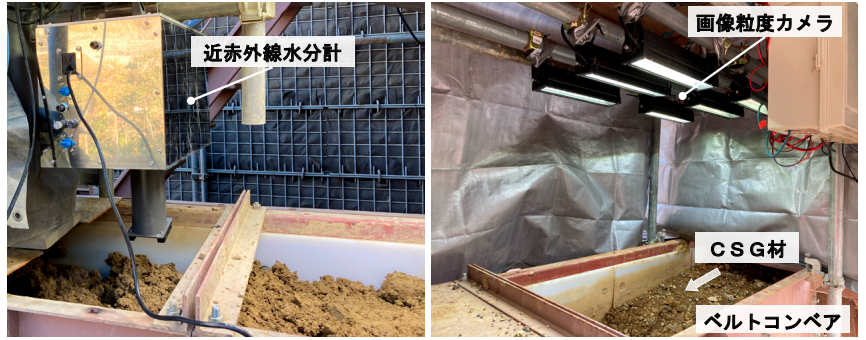
Photo 2 NIR水分計とAI画像粒度の設置状況 (On-site Apparatuses Installation)
