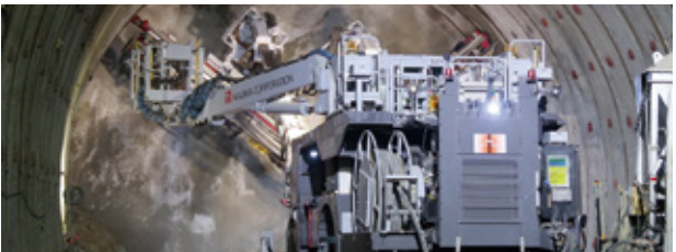
A-CSEL for Tunnel
