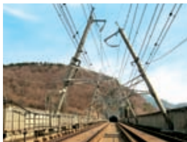
電架柱。被災直後（国見工区）
