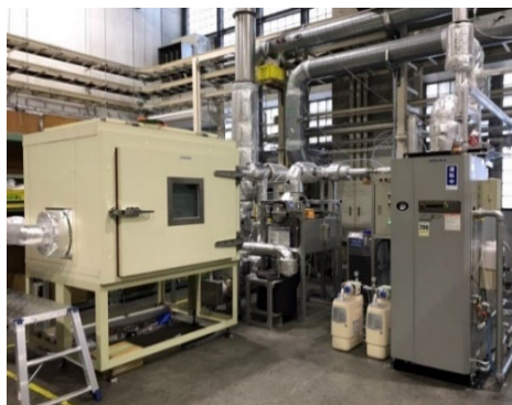
製造試験設備外観 (東京ガス千住テクノステーション)
