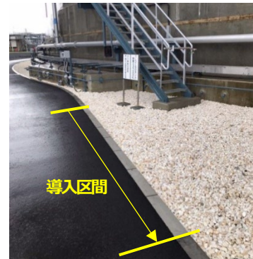
導入状況 (東京ガス日立LNG基地)
