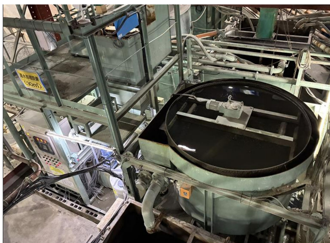
本システムを適用した濁水処理装置
