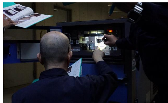
非常用発電機を起動する様子(社員寮)
