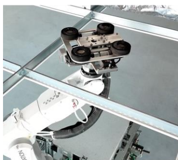
天井裏のセンシング
