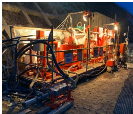
自動グラウチング用注入プラント
