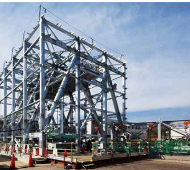
長周期地震動を抑える制震技術「D 3 SKY ® 」モックアップ実大試験体。事前の施工方法検証や性能確認のため、鹿島の機械技術センターで実施された
