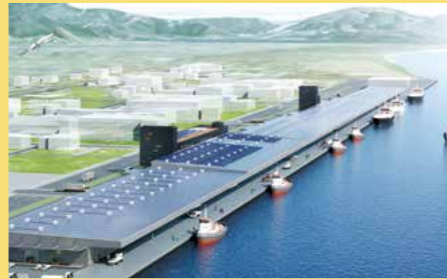
6万3,445㎡の敷地に国内最大級の長さ875m、幅34mの建屋を建設中
