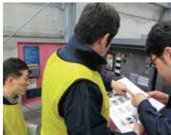
休日BCP訓練で技術研究所 の非常用電源操作
