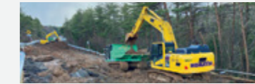
石川県のと里山海道(越の原IC~六水IC間)道路啓開対応
