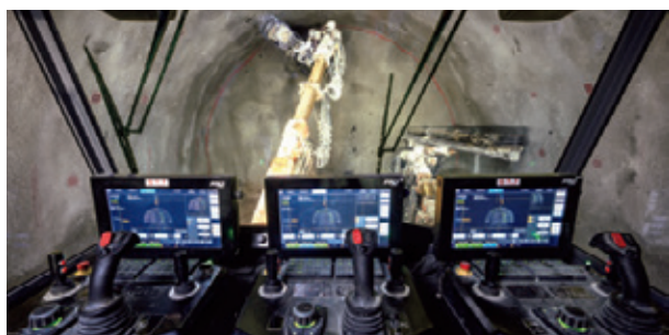
最適自動発破設計システムで稼働するフルオートコンピュータジャンボの操縦室
