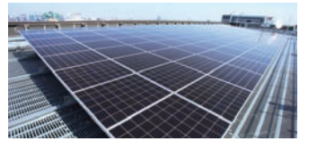
太陽光パネル
