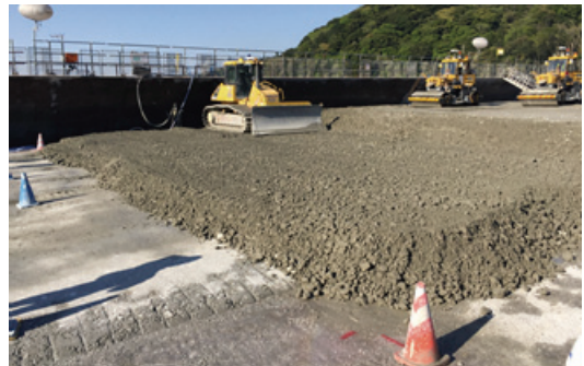
Photo 5 RCD コンクリート自動まき出し・整形状況 (Situation of Automatic Spreading and Fixing)
