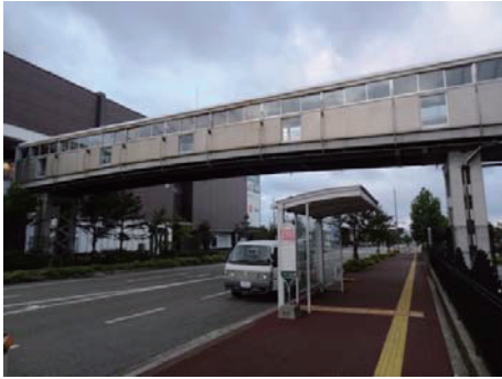
Fig.1 ひび割れ検知モニタリング中の歩道橋 (Pedestrian Deck to be Monitored)
