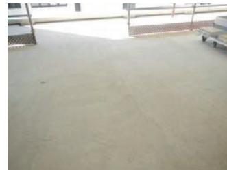
Photo 2 デッキスラブに適用したBLSコンクリート (BLS Concrete for Deck Slab)
