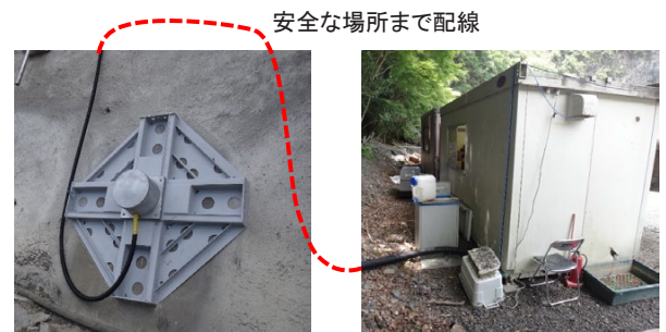
Photo 3 長期計測用の光ファイバ配線状況 (Optical Fiber Wiring for Monitoring)
