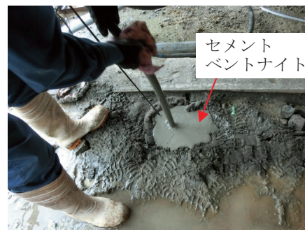
Photo 4 セメントベントナイトによる光ファイバ計測孔の充填状況 (Cement-Bentonite Grout Filled for Borehole)
