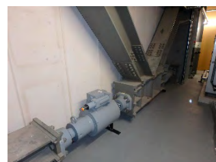
Photo 2 HiDAX-e 設置状況 (Exterior of HiDAX-e)
