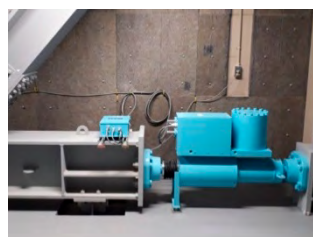
Photo 1 HiDAX-R 設置状況 (Exterior of HiDAX-R)
