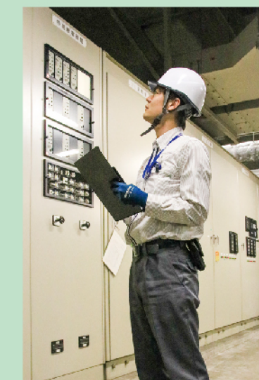
建物設備管理
